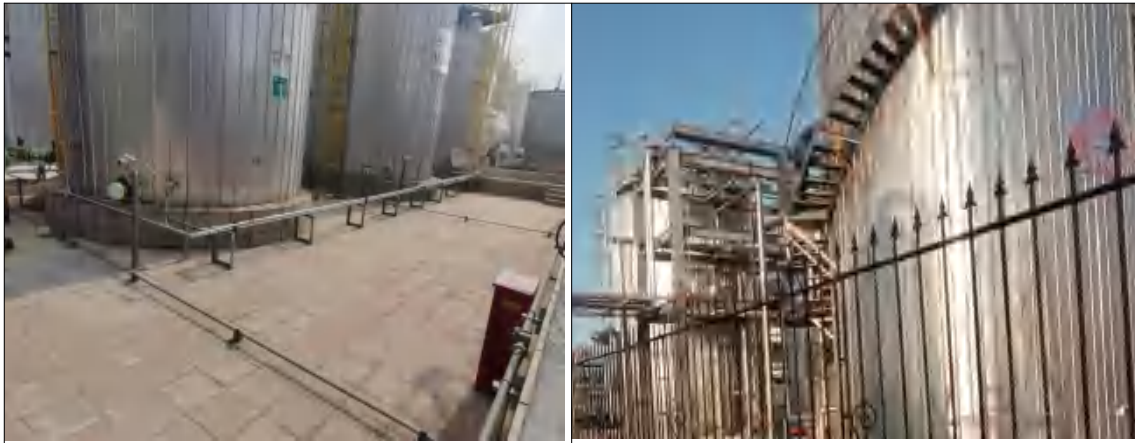
3#罐区现场情况
