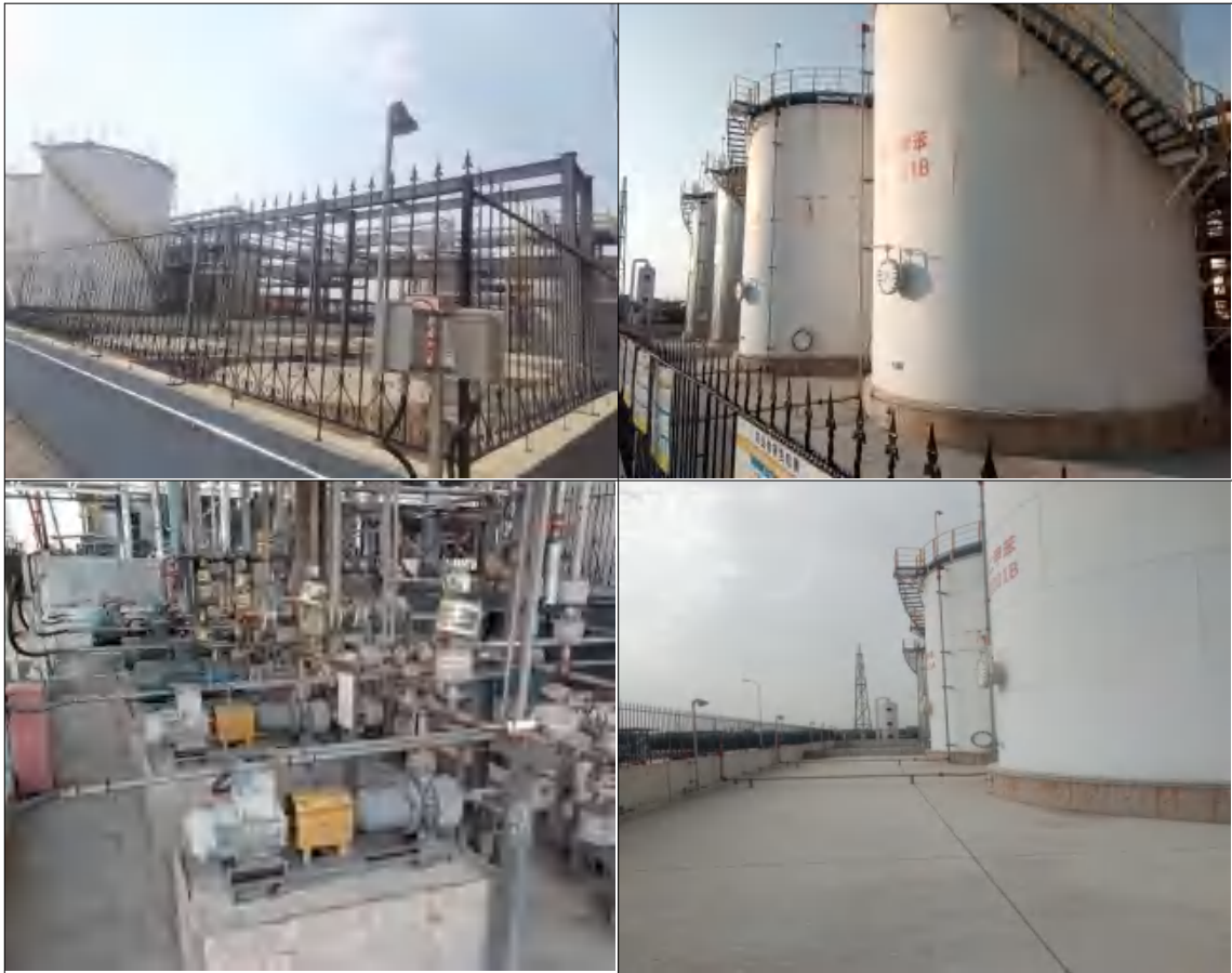
1#罐区现场情况
