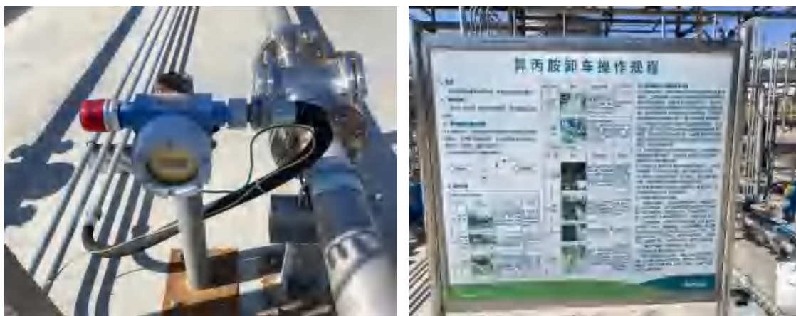
卸车区泄漏物料报警仪
