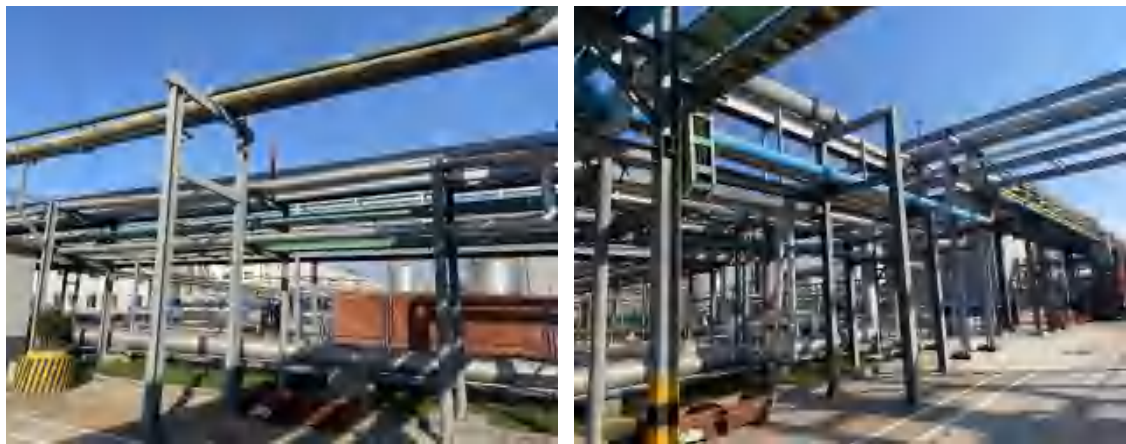
厂区物料运输管道
