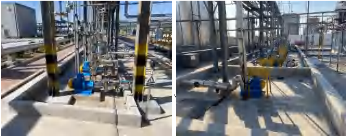
中部罐区运输机泵
