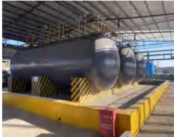
三氯化磷储罐
