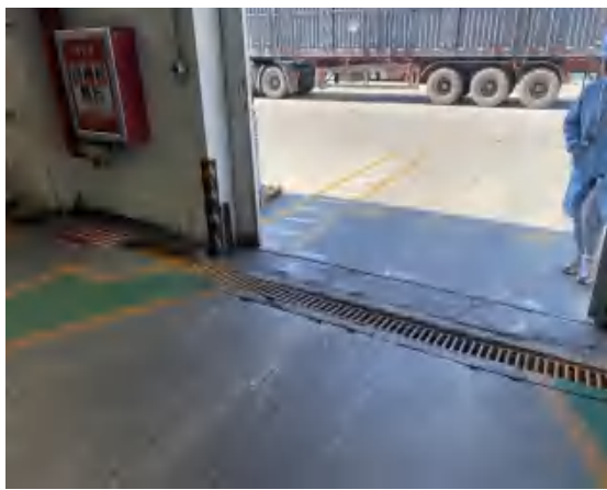
成品库门口泄漏液体收集设施
