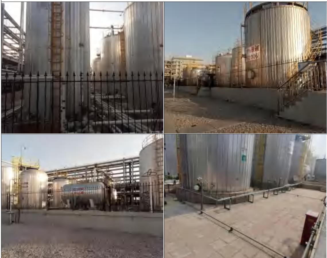
2#罐区现场情况
