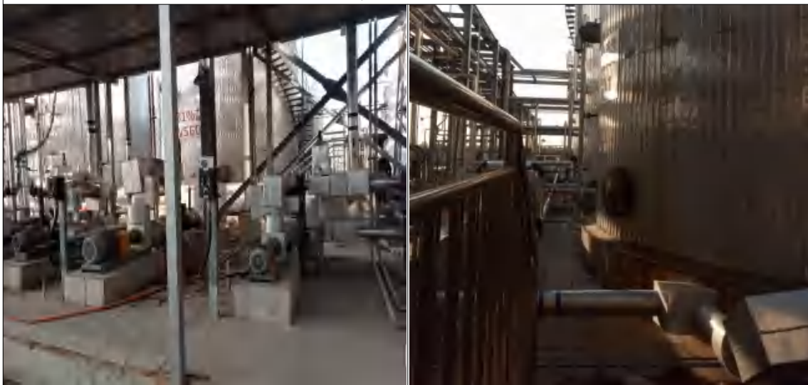
5#罐区现场情况
