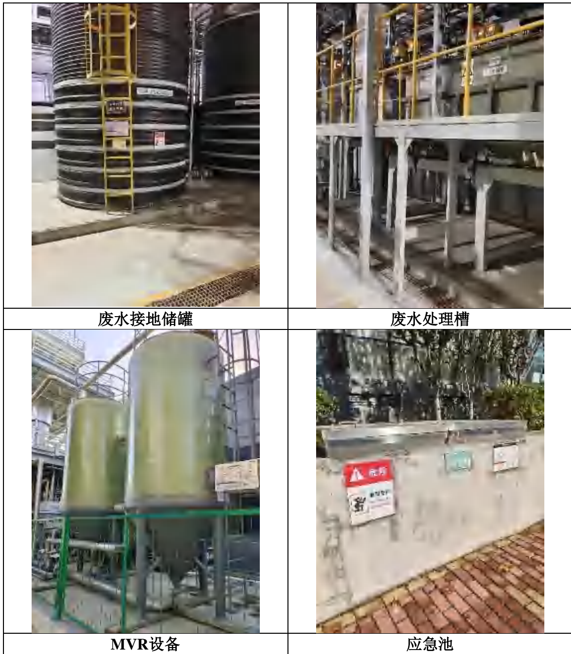
图5.1-1 液体物料存储现场照片
