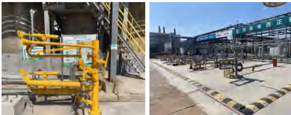
中部罐区卸车区域
