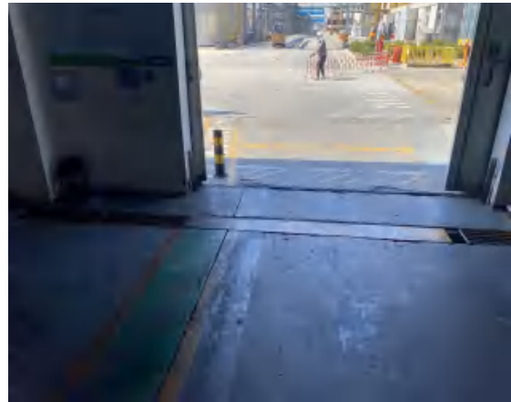
原料库门口泄漏液体收集设施
