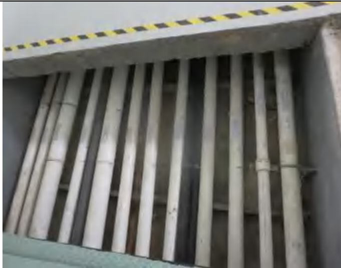
废水分类收集管道（管沟内）
