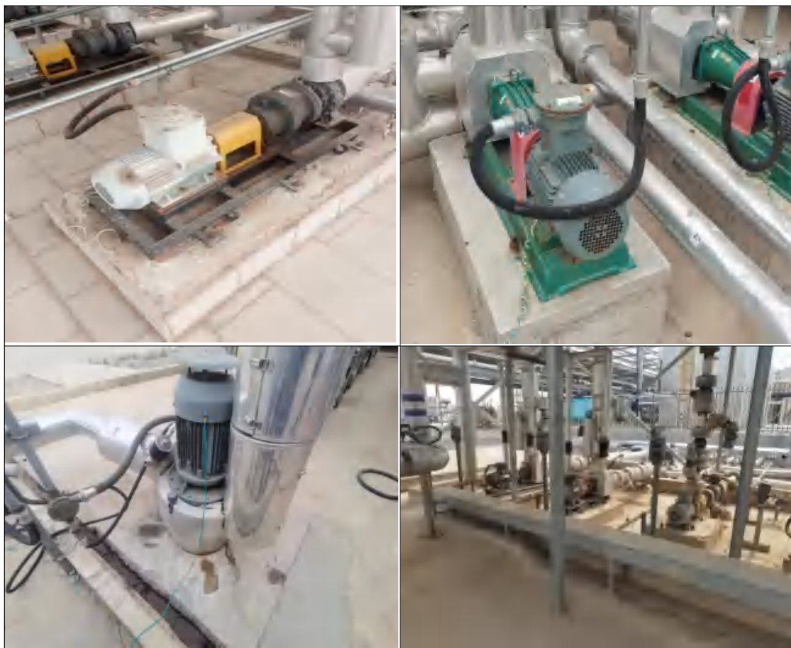
图 4.1-6 传输泵现场情况图
