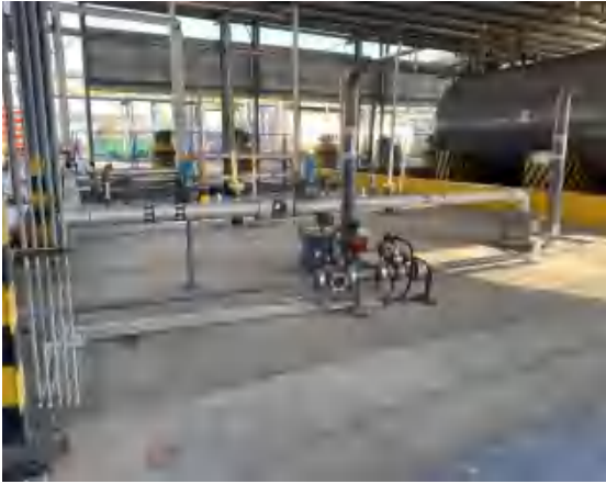
黄磷地下储罐
