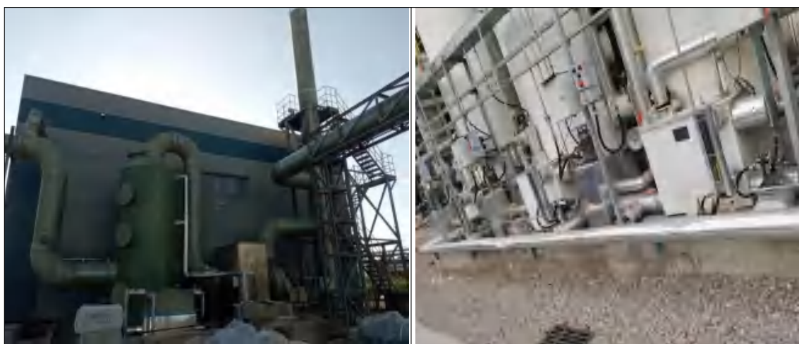
图 4.1-9 企业废气处理设施情况
