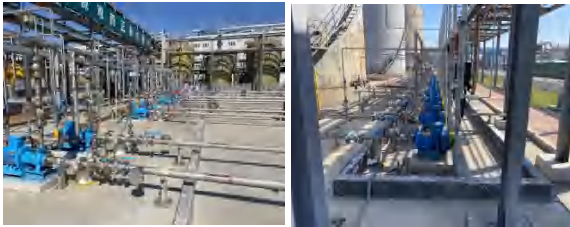
原料罐区运输机泵
