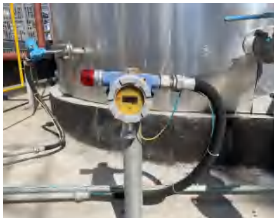
罐区泄漏气体报警装置
