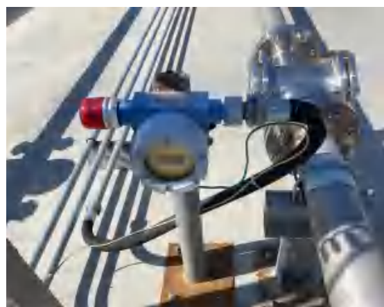
卸车区泄漏气体报警装置
