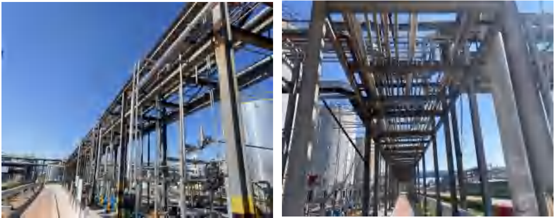
厂区物料运输管道
