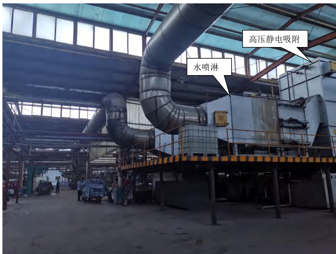
图 4-1 废气治理设施现场照片
